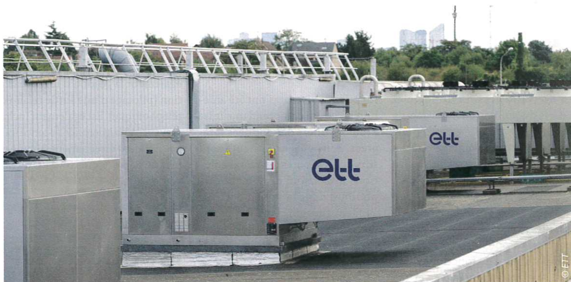
Rooftop ETT sur une surface commerciale à Paris.
