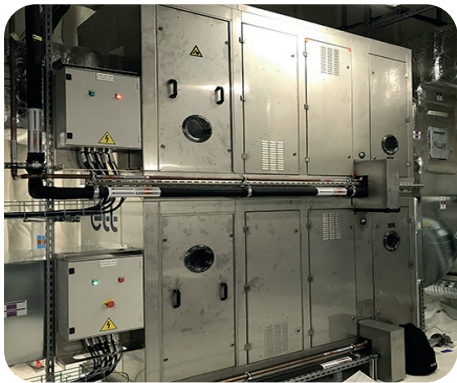
AHU de pressurisation
