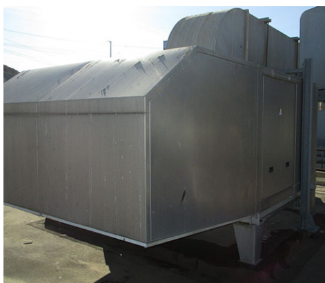
Roof Top pomieszczenie elektryczne (Alu A64)
