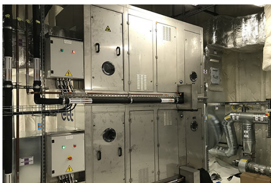
AHU utrzymująca ciśnienie
