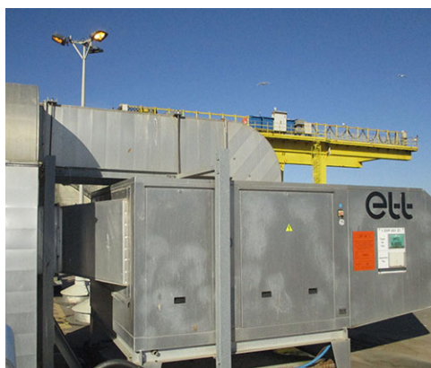
Roof Top pomieszczenie elektryczne (Alu A64)
