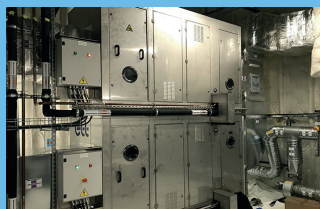
AHU pour pressurisation
